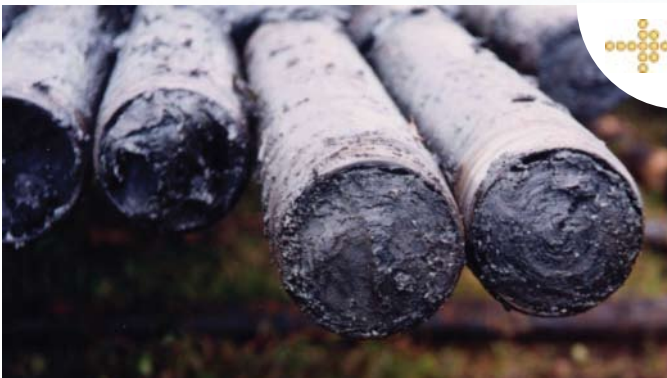
Tubería de Producción totalmente obstruida por depósitos de compuestos pesados del crudo
